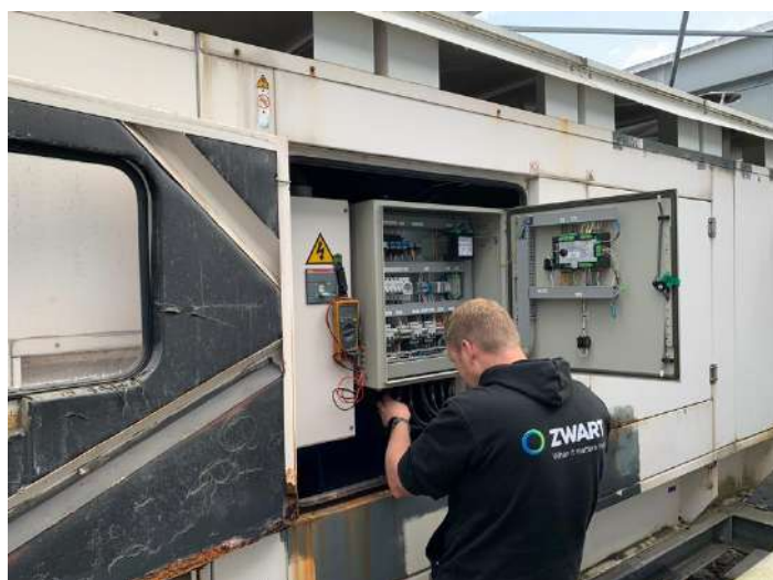
Afkoppeling 250 kVA aggregaat (specialist Zwart techniek)
